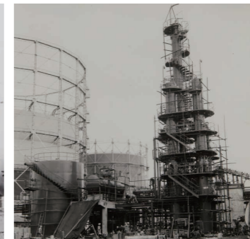
港明工場排水処理用フェノール抽出装置
